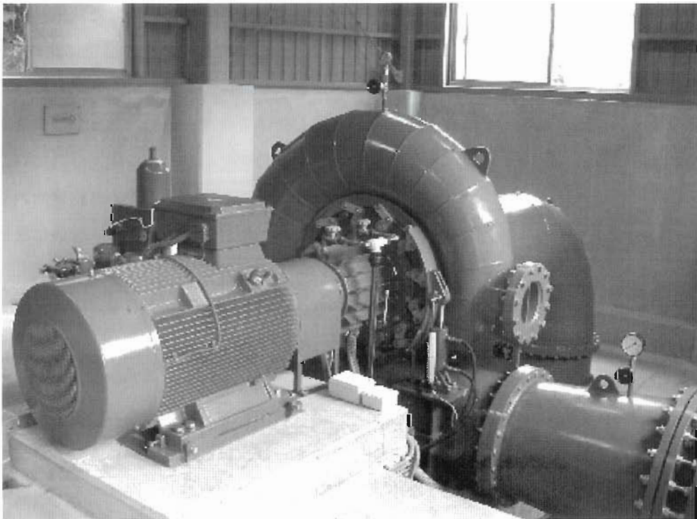
図6 山一水力発電所(山梨県富士吉田市) (フランシス水車落差16.4m、流量1.0m 3 /s、出力132kW)
